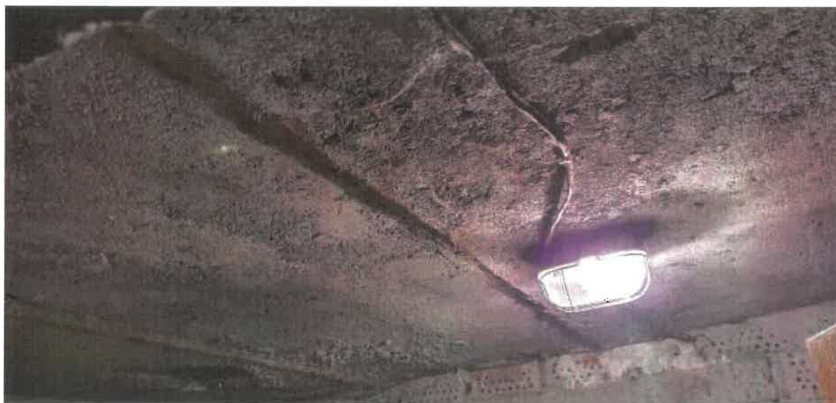
10 pav. Elektros instaliacija rūsyje
