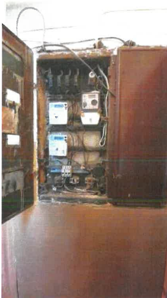
13 pav. Elektros instaliacija rūsyje
