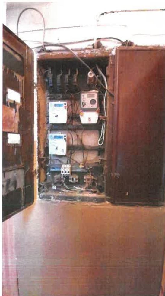
16 pav. Elektros instaliacija rūsyje
