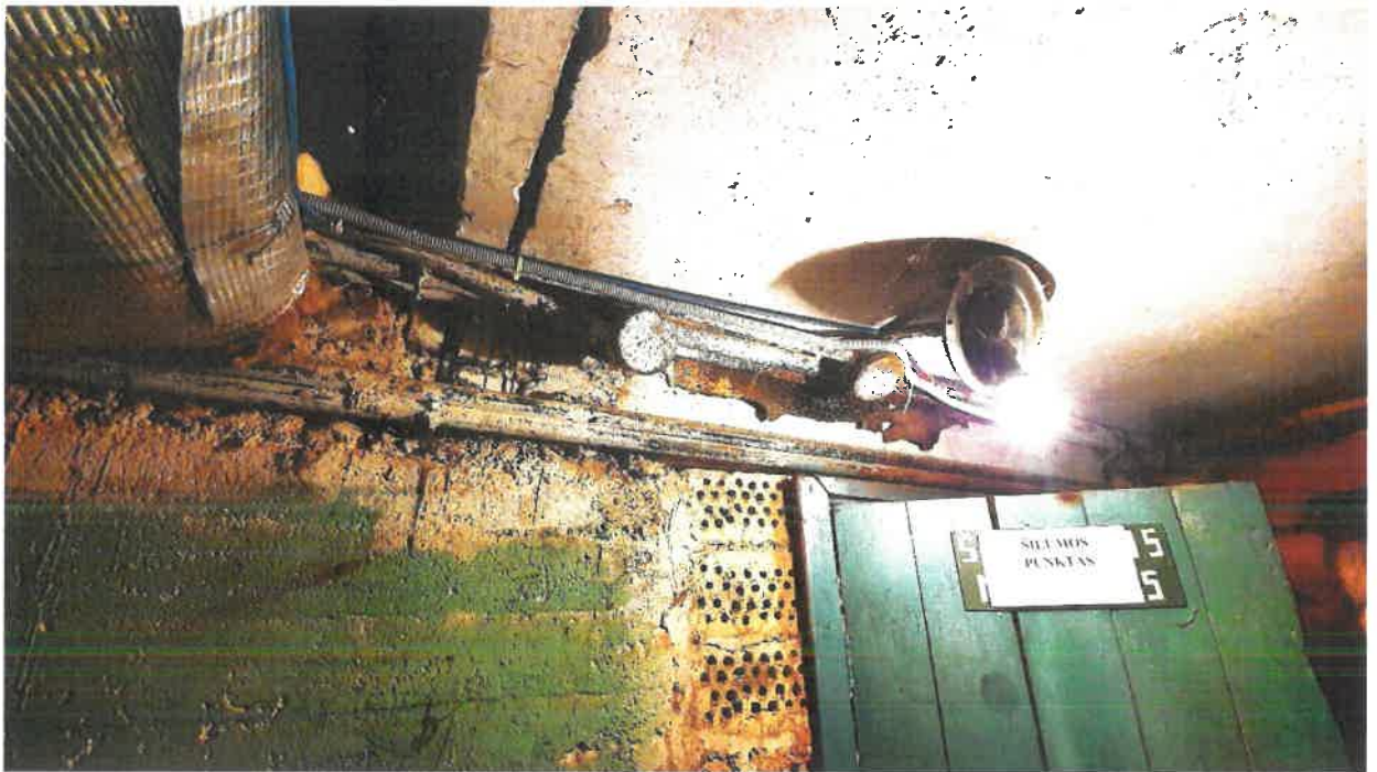
15 pav. Elektros instaliacija rūsyje
