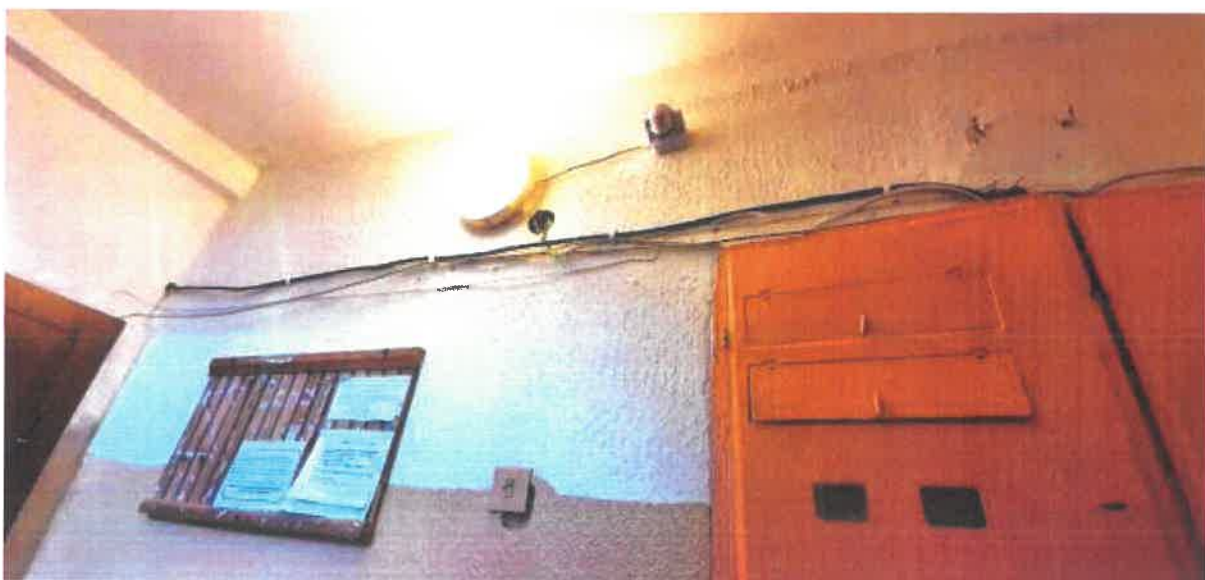
12 pav. Elektros instaliacija laiptinėse
