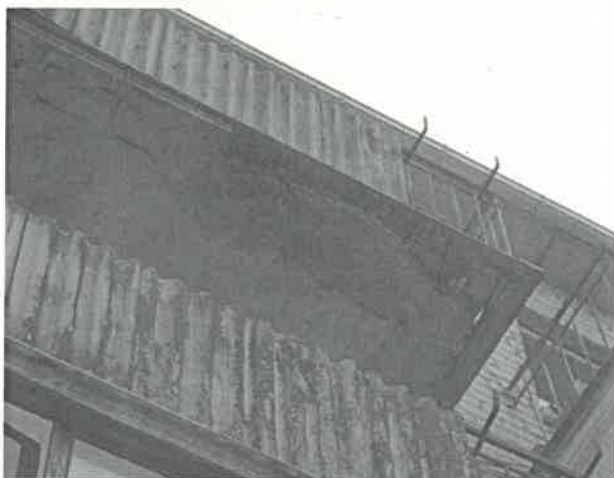
3 pav. Balkonų perdangos būklės fragmentas.
